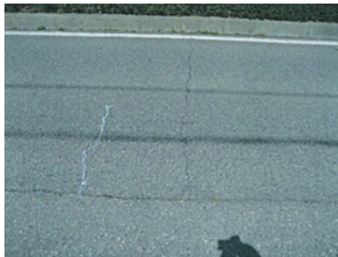
舗装のひび割れ現状
