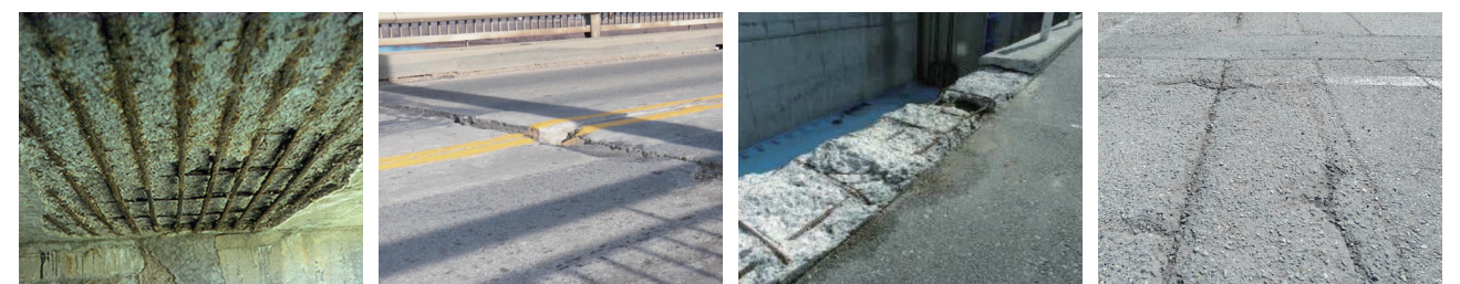
① 床版の漏水からくる障害 ② ジョイント部の漏水からくる障害 ③ 地覆部の漏れからくる障害 ④ 橋梁舗装のひび割れの漏水からくる障害
